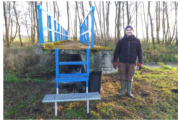
Abb. 5.13.: Durch den Moorschwind liegt die Geländeoberfläche in der Friedländer Großen Wiese etwa 1 m tiefer als ca. 1970, als die Betonbrücke gebaut wurde. Zum Größenvergleich: Javier Gargiulo (HU Berlin). Foto (März, 2021): ©G.L. Constantin
